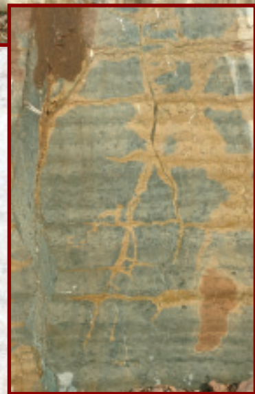
Entfärbungen, ausgehend von Klüften und Schichtfugen, Lienbacherbruch Kiefer
